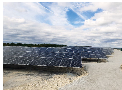
Centrale solaire de Villognon
